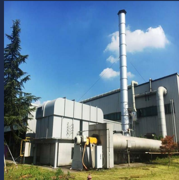
上海外置式RTO,2002年安装 Shanghai External,2002
